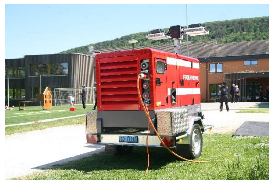
Von der Solothurnischen Gebäudeversicherung zur Verfügung gestellt: Ein mobiler Notstromgenerator mit einer Leistung von 34.8 Kilowatt. (Foto: H. Baumann)
